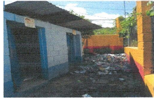
Foto 2 La siguiente imagen nos muestra el deterioro y la falta de accesorios para brindar un buen servicio hacia la niñez
