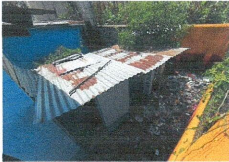
Foto 1 La imagen nos muestra la precariedad del lugar de los servicios sanitarios para el nivel preprimaria.
